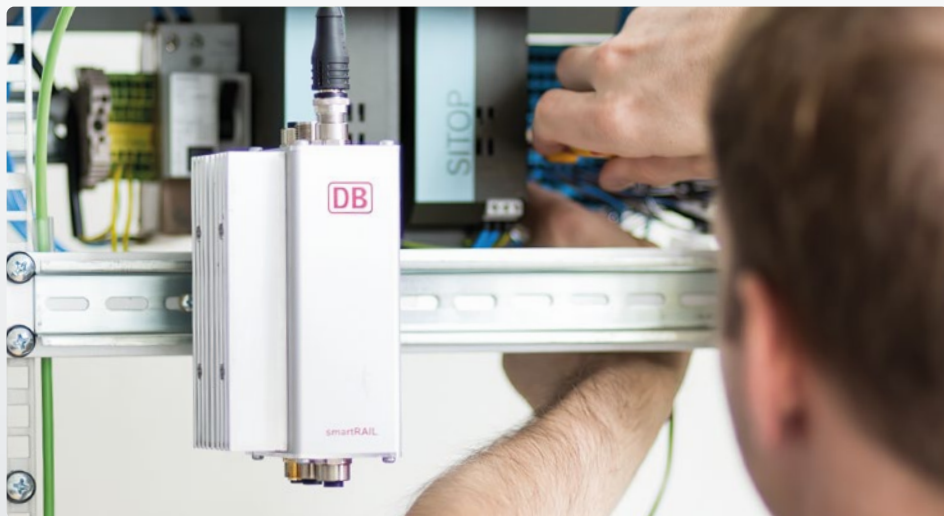
Einbau eines smartRail im Schaltschrank eines Instandhaltungsfahrzeugs.
